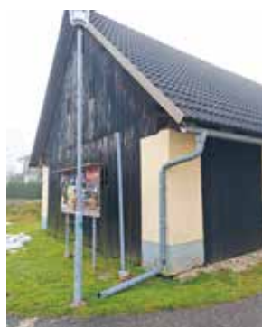
So darf eine Ableitung von Niederschlagswässern nicht erfolgen
